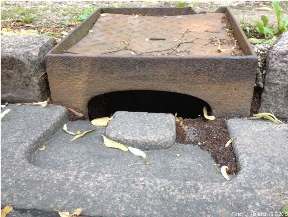
Abbildung 2: Veralteter Seitenablauf mit ungenügender Leistungsfähigkeit
