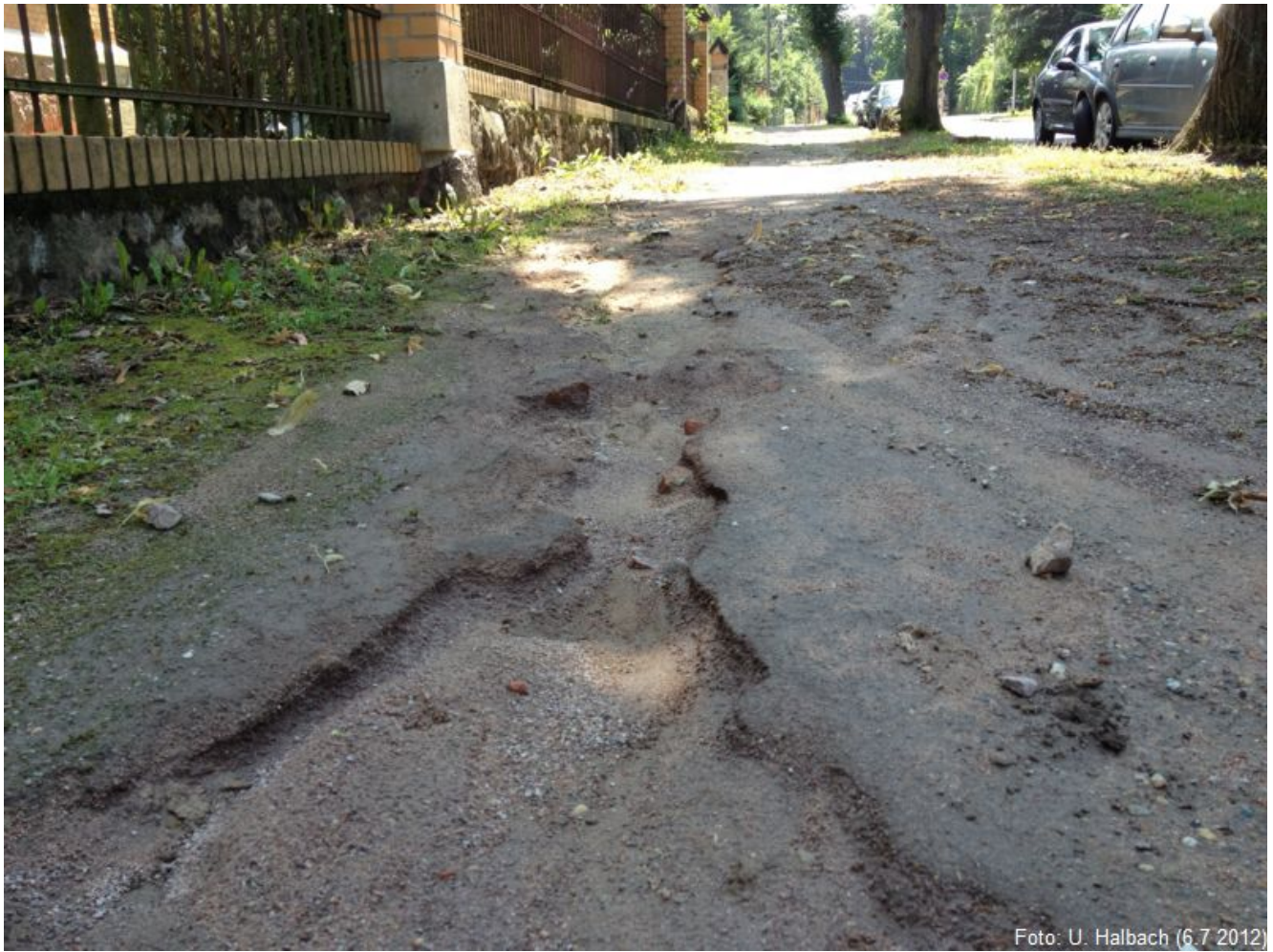
Abbildung 6: Erosionen auf dem Fußweg
