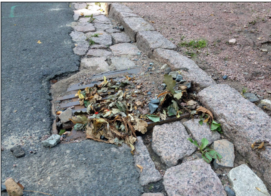
Abbildung 1: Straßenablauf durch Abschwemmung verstopft
